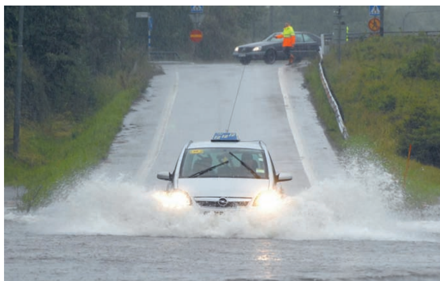
Översvämningen på den inre ringvägen i Malmö kl 16 torsdagen 5 juli 2007.
